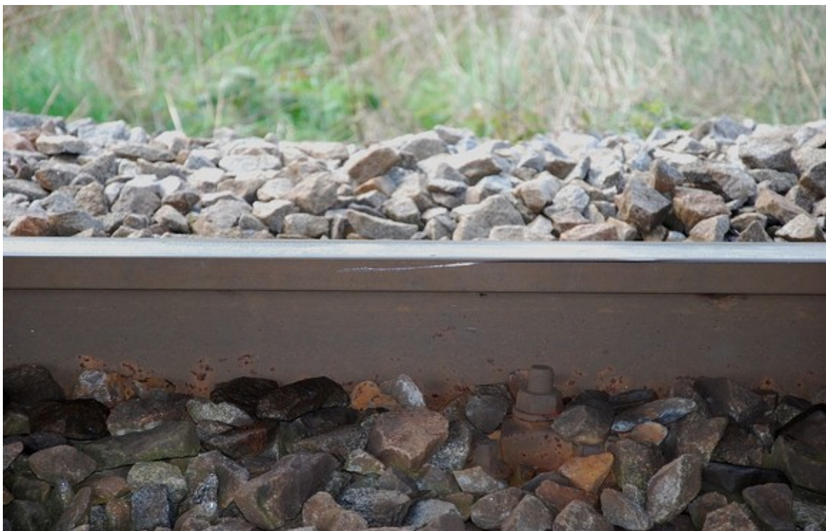
Obr. č. 4: Stopa na pojížděné hraně pravé kolejnice, kde kolo sjelo z temena kolejnice.
