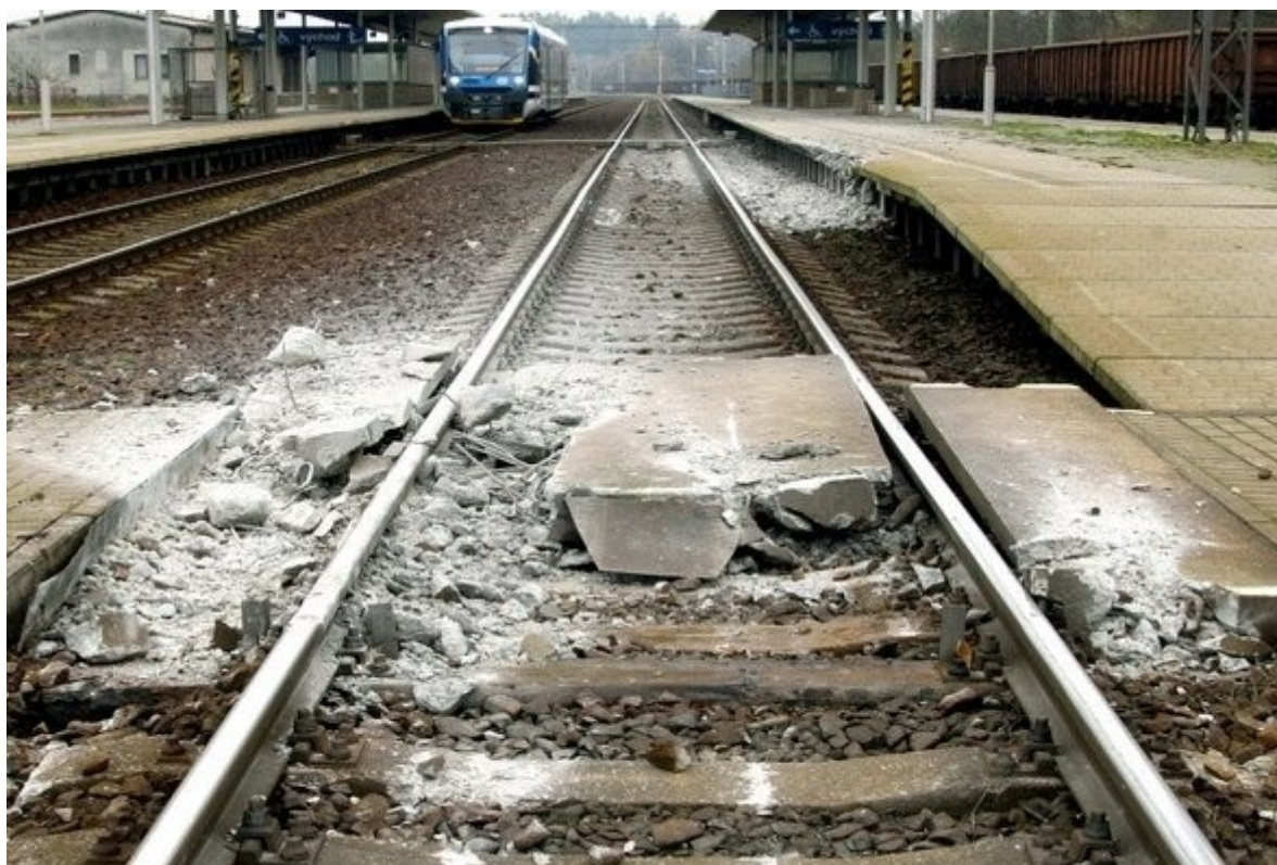
Obr. č. 13: Ukázka poškození služebního přechodu a nástupiště před dopravní kanceláří v žst. Příbyslav
