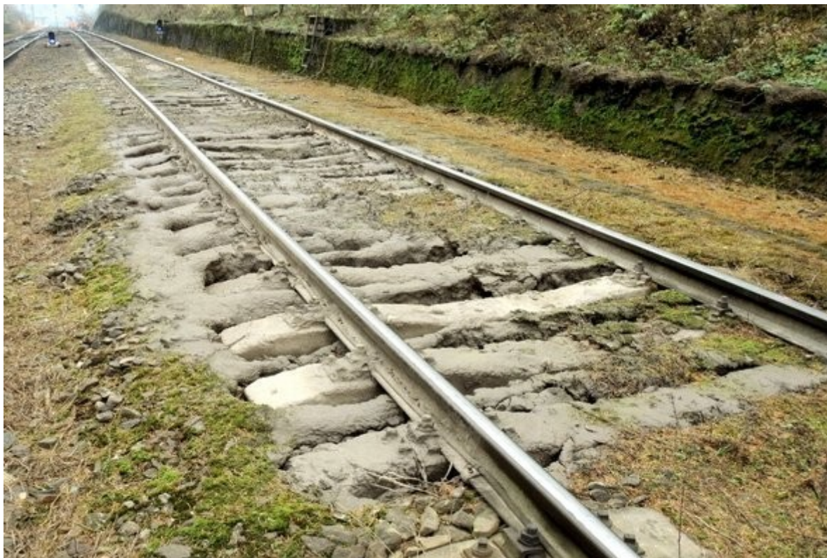
Obr. č. 10: Stav blátivého místa po vykolejení dne 14. 11. 2014
