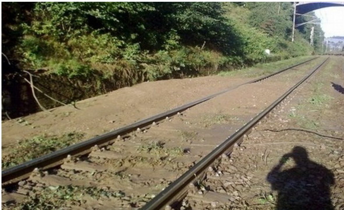
Obr. č. 8: Zaplavení trati po bouři v září 2011
