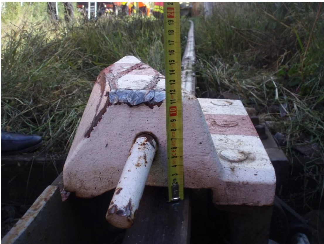
Foto č. 3: Poškozená výkolejka ve vysoké, po MU již sešlapané trávě (foto SŽDC, s. o., Odbor šetření MU)
