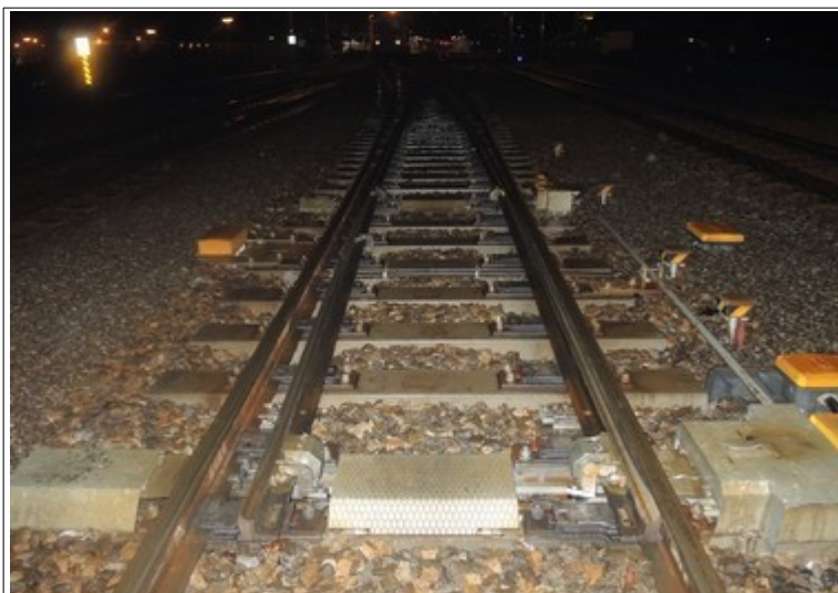
Obr. č. 6: Výhybka č. 35 přestavena do odbočného směru
