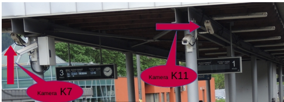
Obr. č. 3: Pohled na kamery umístěné na nástupišti č. 1 v žst. Ústí nad Orlicí
