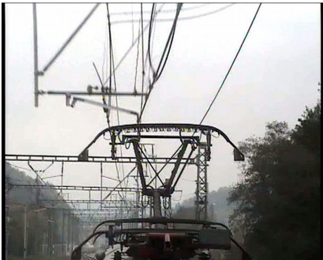
Obr. č. 4: Stav polohy TV – vjezd do místa dělení TV, stožár č. 129
