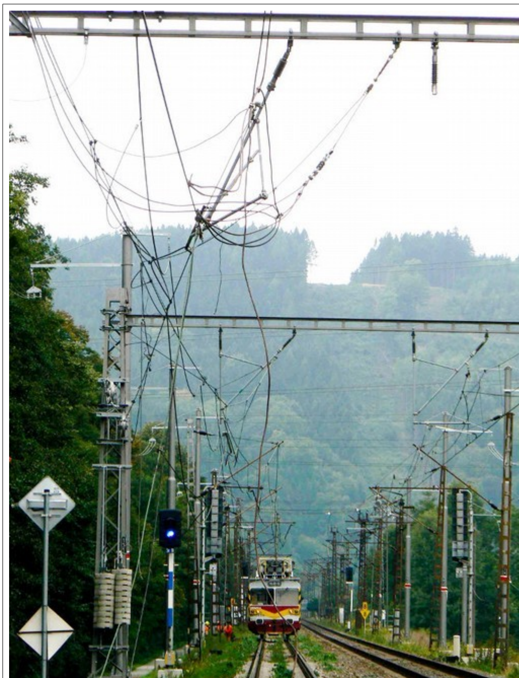
Obr. č. 12: Pohled na poškozené TVT od stožáru č. 129
