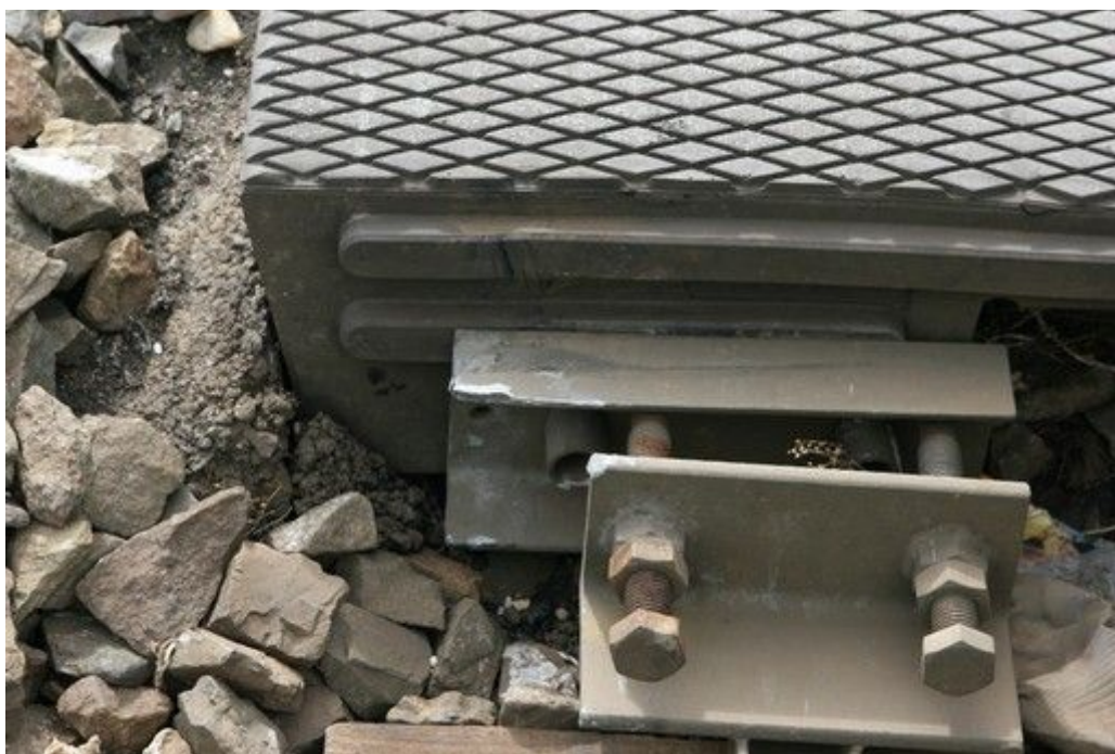
Obr. č. 14: Stopy po nárazu do čela konstrukce přejezdové vozovky přejezdu P 4933
