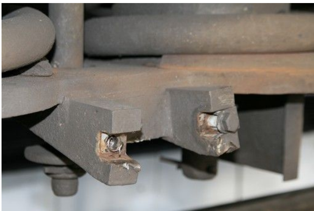
Obr. č. 5: Poškození dolní konzole tlumiče a chybějící nosič sekundárního vypružení Zdroj: Drážní inspekce
