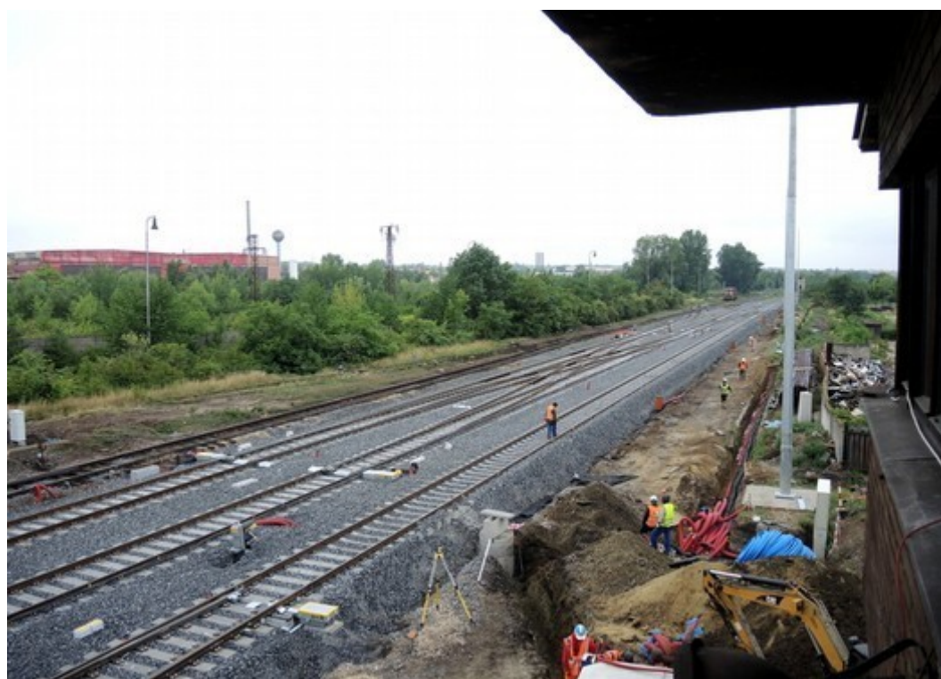
Obr. č. 9: Rekonstrukce SZZ na bzeneckém zhlaví v žst. Veselí nad Moravou
