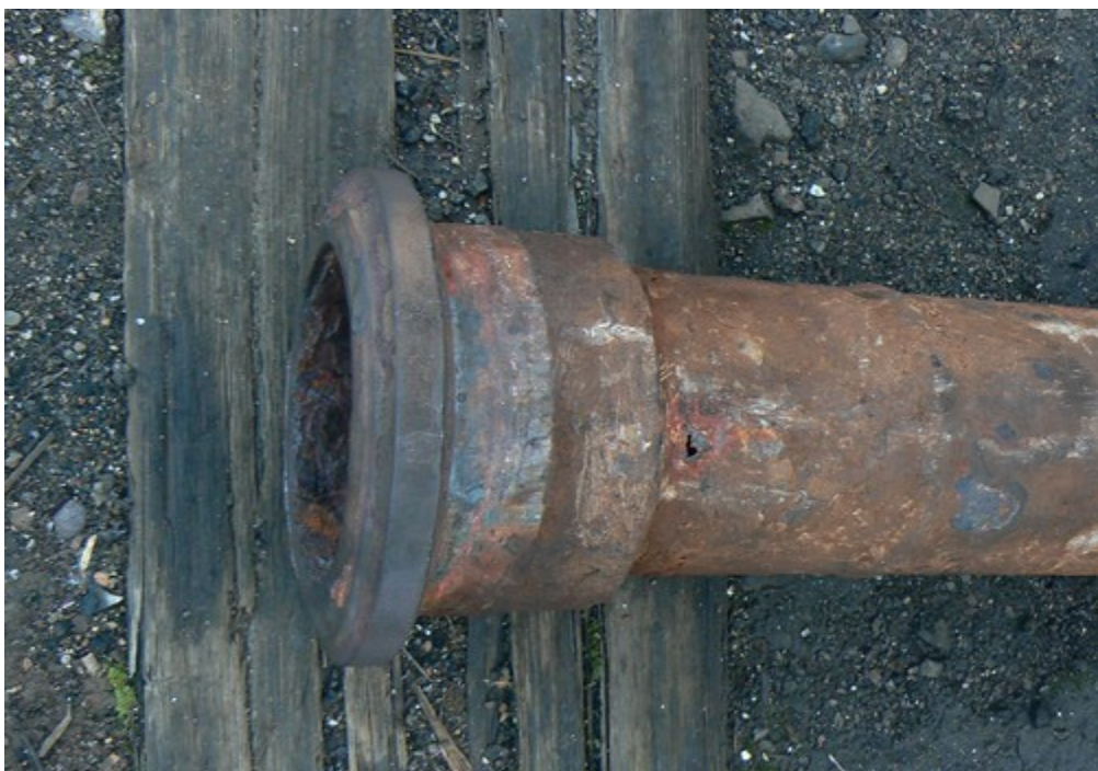
Obr. č. 12: Pohled na poškozenou přítokovou rouru parní lokomotivy 423.0145
