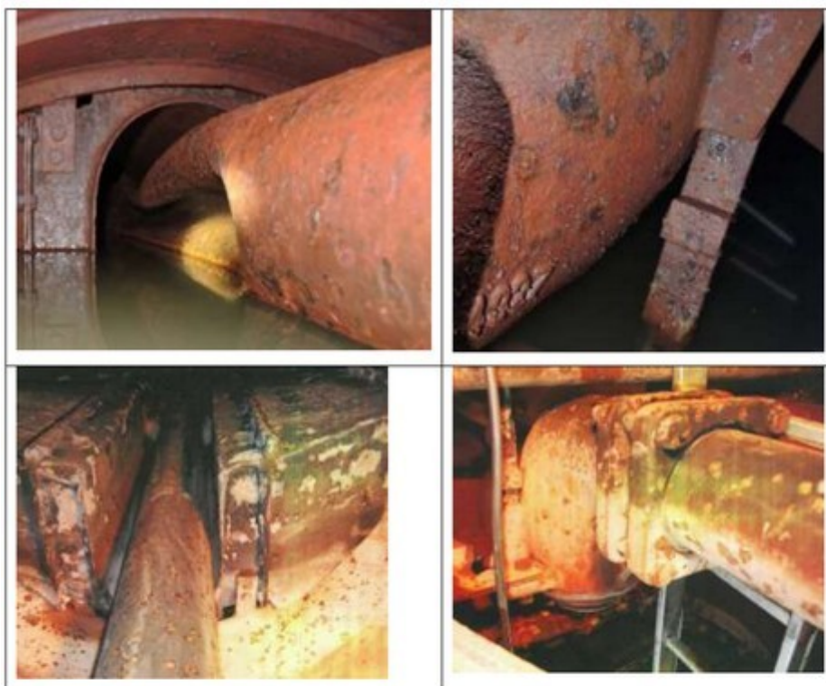
Obr.3 Fotografie dodané Drážní inspekci, dokumentující rozsah kyslíkové koroze v horní části lokomotivního kotle po vzniku předmětné mimořádné události. Na horním obr. vlevo je zřejmě patrná deformovaná trubka odvodu páry na úrovni hladiny kotelní vody. Na spodním levém obr. by tmavá místa na povrchu vnitřních stěn mohla odpovídat reliktvům magnetitových vrstev, vytvořených ještě v dobách pravidelnějšího provozu kotle lokomotivy
