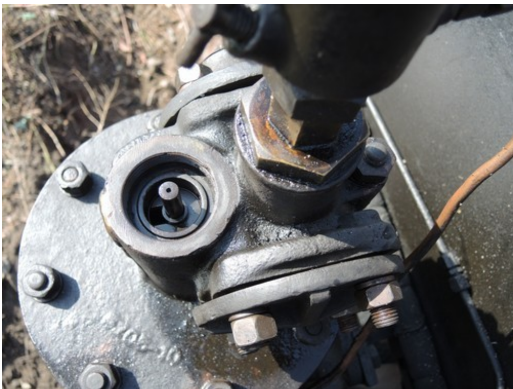
Obr. č. 4: Pohled na vrchní část kompresoru
