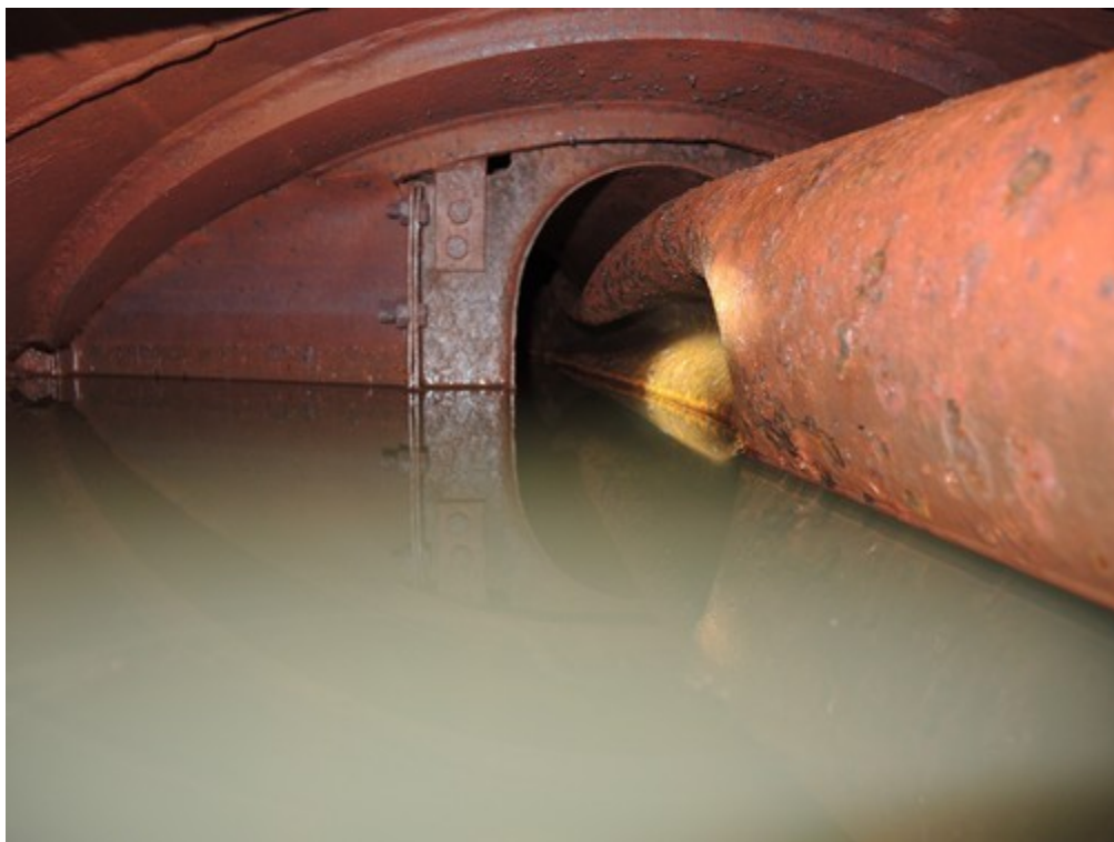
Obr. č. 7: Pohled na deformovanou přítokovou rouru v lokomotivním kotli Zdroj: DI
