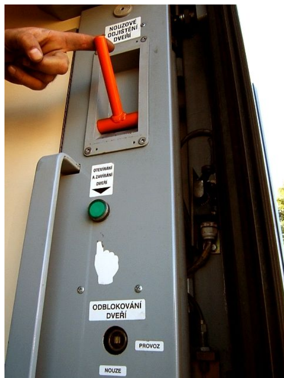
Foto 4: Nouzové odjištění dveří vozu řady Bdtn 756 („kladívko“ – viz bod 3.1.1 – vlakvedoucí vl. Os 4813, 4. odrážka)
