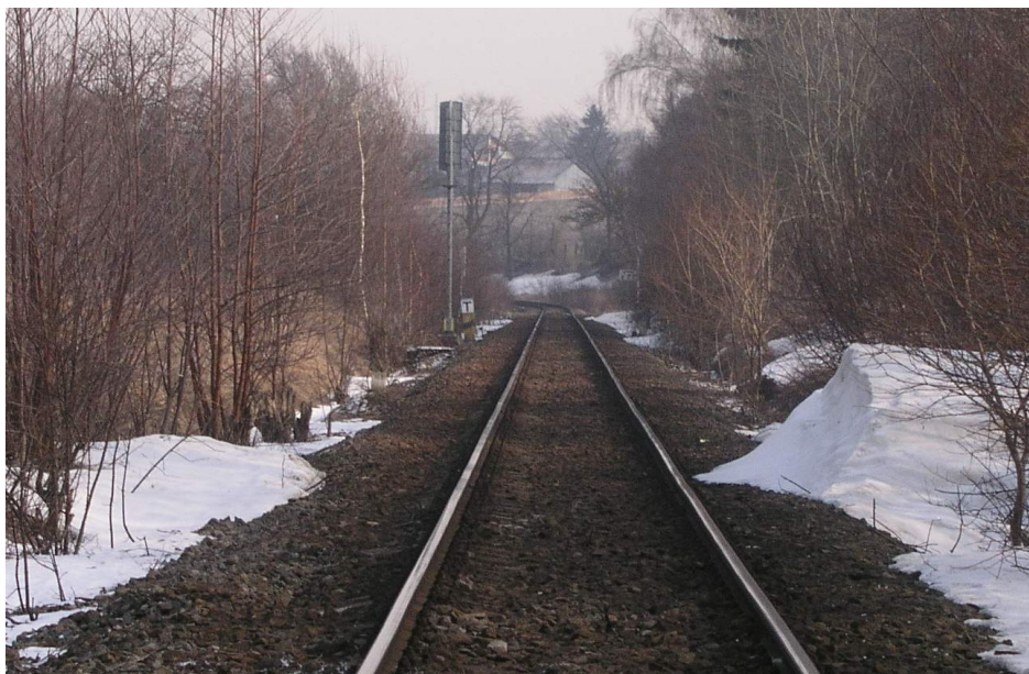
Foto 2: Místo srážky a vykojení, stav k 23. 2. 2011
