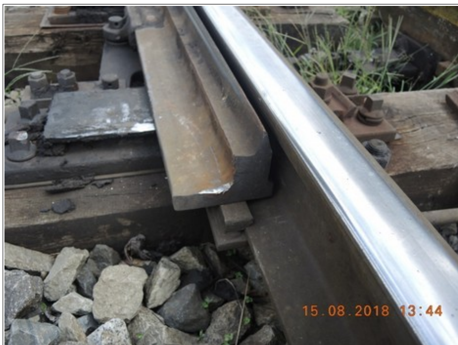
Obr. č. 10: Pohled na otlak na pravém ohnutém jazyku výhybky č. 914 žst. Praha-Vršovice s. n. způsobený vykolejeným pravým kolem 1. nápravy podvozku „a“ TDV 84 54 6680 739-1, řazeného jako 17. TDV za HDV.
