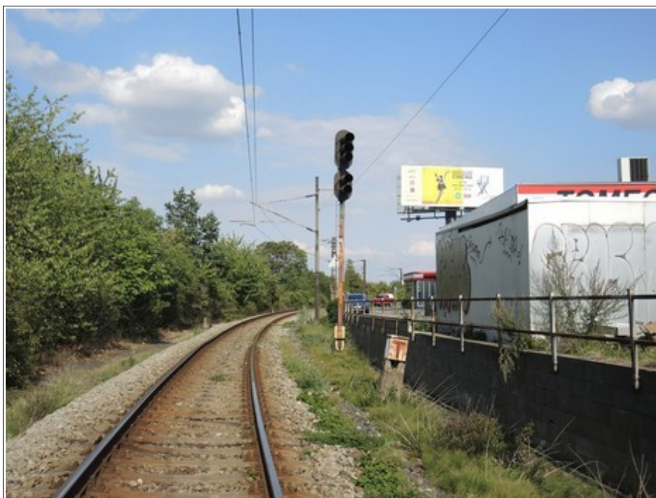
Obr. č. 11: Pohled na vjezdové návěstidlo KS žst. Praha-Vršovice s. n. s nátěrem stožáru poškozeným korozí.
