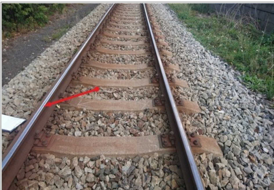
Obr. č. 8: První stopa po vykolejení – bod „0“, v km 1,992.
