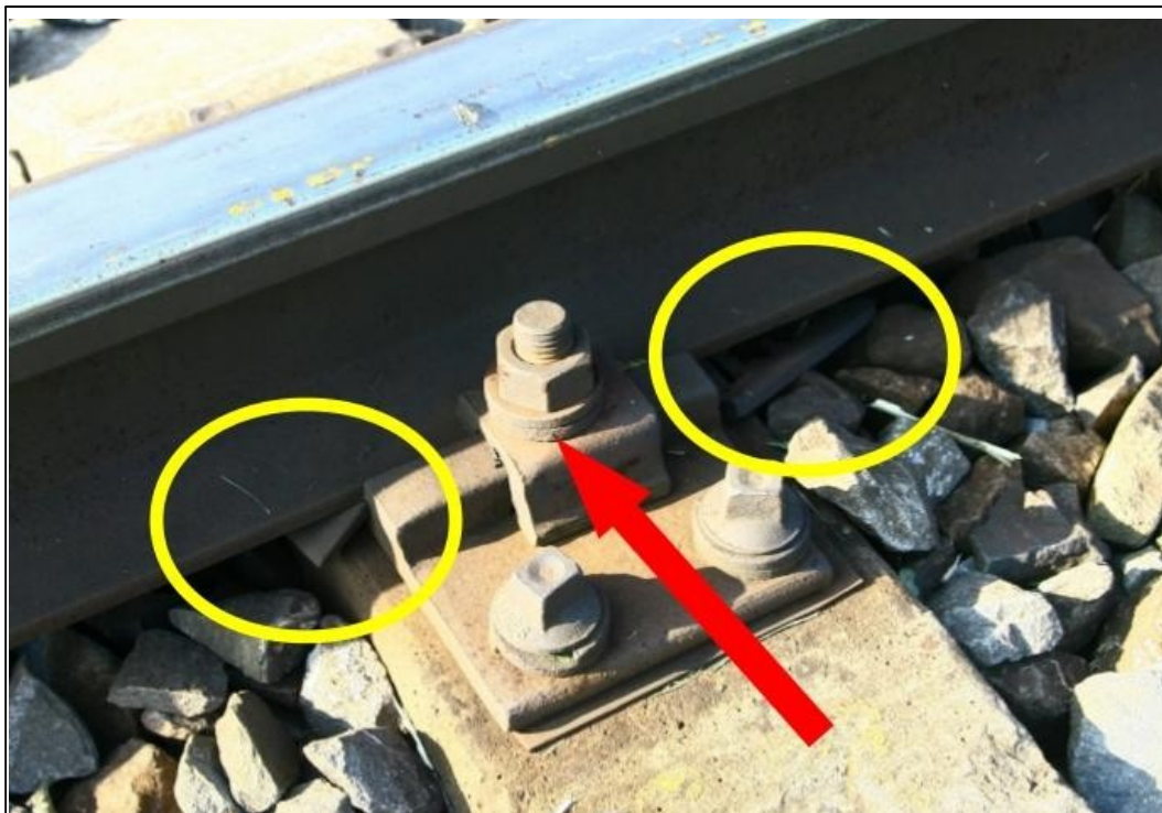
Obr. č. 6: ukázka stavu upevnění po jeho dotažení – nevyměněná vadná pryžová podložka pod patou kolejnice, příliš stlačený pružný dvojitý kroužek, nenamazaný šroub.
