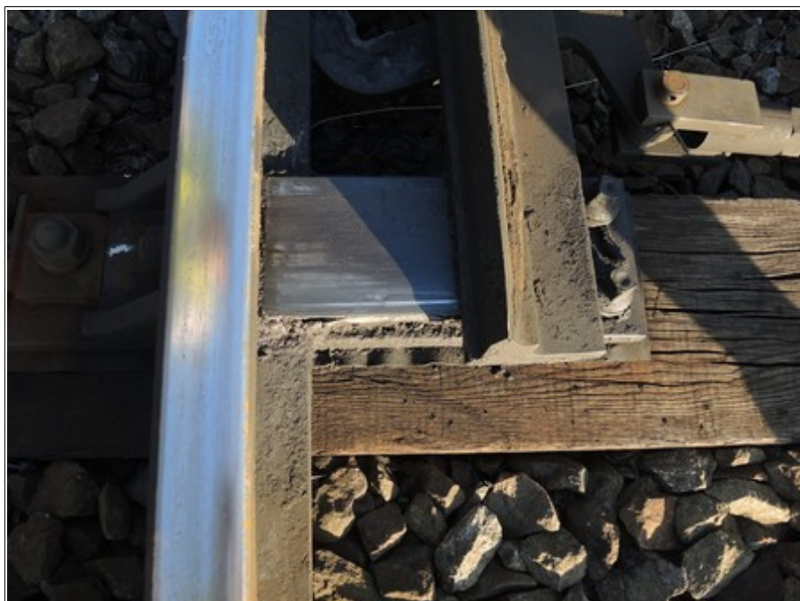
Obr. č. 5: Rýha na první kluzné stoličce výhybky č. 1
