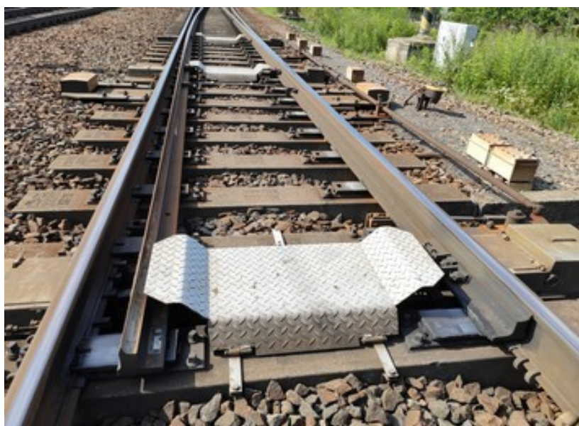
Obr. č. 3: Pohled na umístění krytů EOV – výhybka č. 27 v žst. Svitavy
