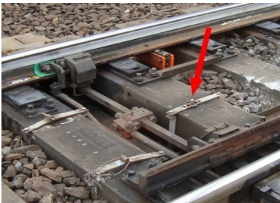
Obr. č. 19: Pohled na nepoškozený čep prvního krytu výhybky č. 5 Zdroj: SŽDC
